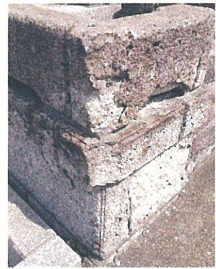
※大谷石劣化の例
